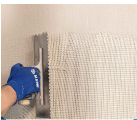
Posizionamento della rete in fibra di vetro A.R. sul primo strato di rasatura
